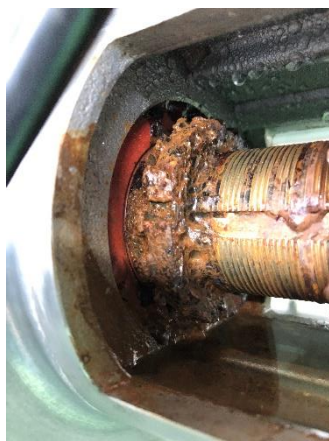
水分や湿気からくる腐食
